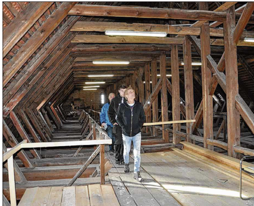
... und dann, nach vielen Stufen, durchs Gebälk des Dachstuhls. Simon Laudy, sein Lehrling Merijn Klugkist und Prüfstatiker Thomas Heinrich sind hier routiniert unterwegs.
