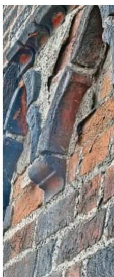
Handlungsbedarf am Bogenfrieß der Ostseite.
